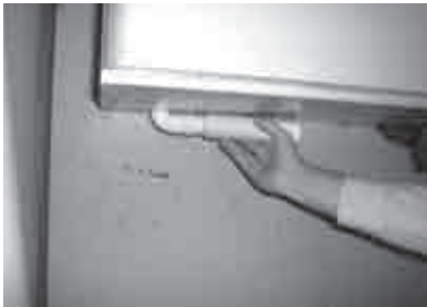
• Uitvoering met een 1-weg klep zonder water.
